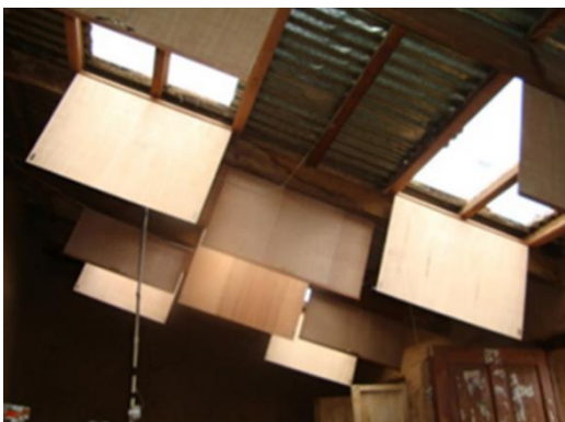
Figura 2. Ventanas térmicas en techo de vivienda.
